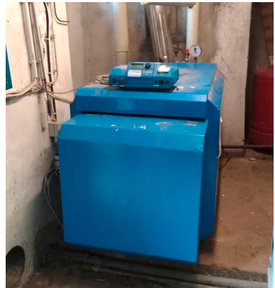
Ölheizung St. Marienkirche alt
